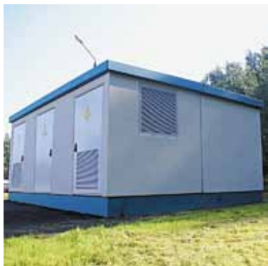
КТП, обеспечивающая спорткомплекс электричеством
