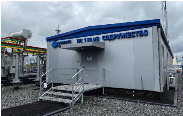
ПС 110/10 кВ «Содружество» введена в работу во 2 кв. 2025 года (Курская обл.)
