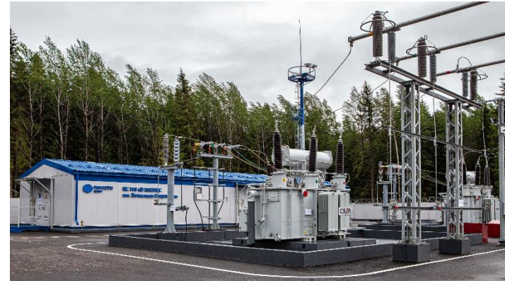
ПС 110/10 кВ «Космос» введена в работу во 2 кв. 2025 года (Тверская обл.)
