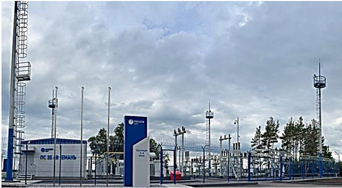
ПС 35/10 кВ «Емань» введена в работу во 2 кв. 2025 года (Воронежская обл.)
