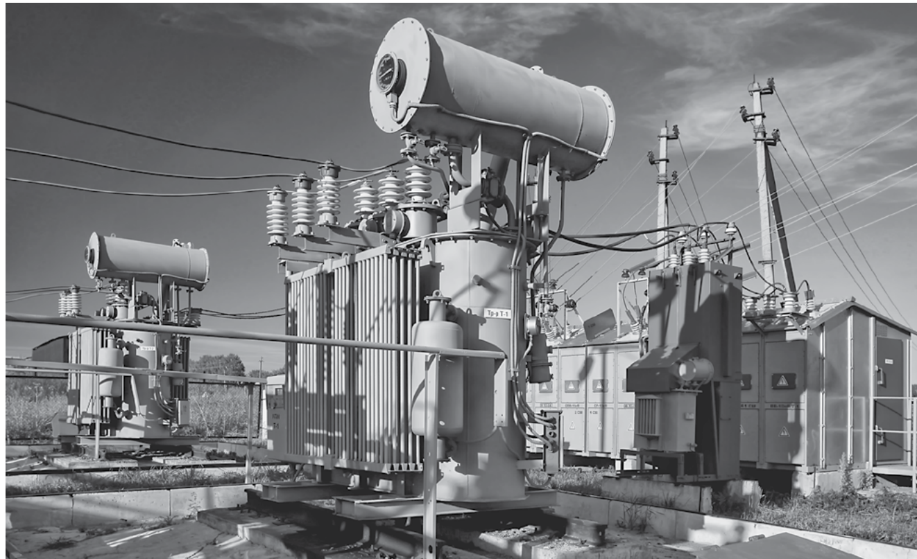
На ПС «Кадый» установят шесть новых трансформаторов
