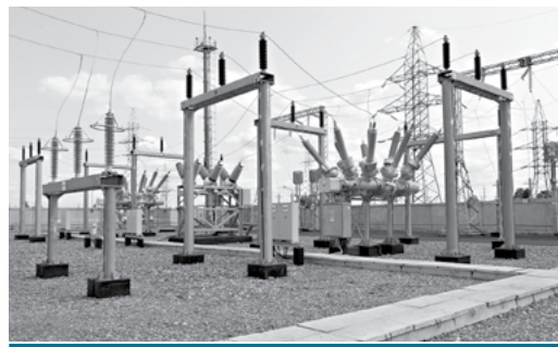
Образовательный центр ЯГПУ имени К. Д. Ушинского будет запитан от одной из самых современных подстанций Ярославской области — «Новоселки»
