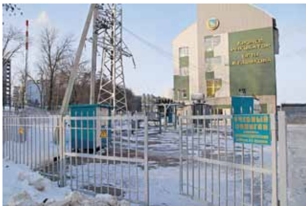
Учебный полигон кафедры электроэнергетики
