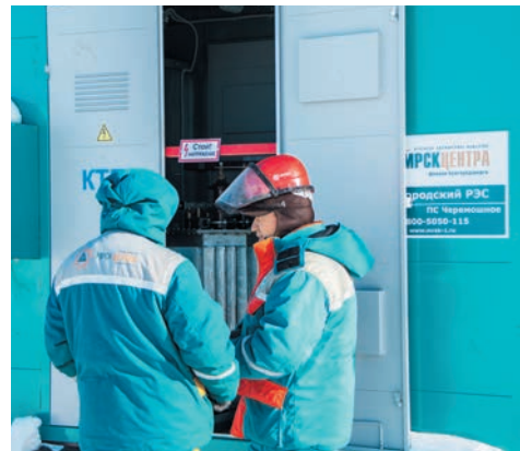
Специалисты Белгородэнерго проводят на трансформаторе тестовые испытания
