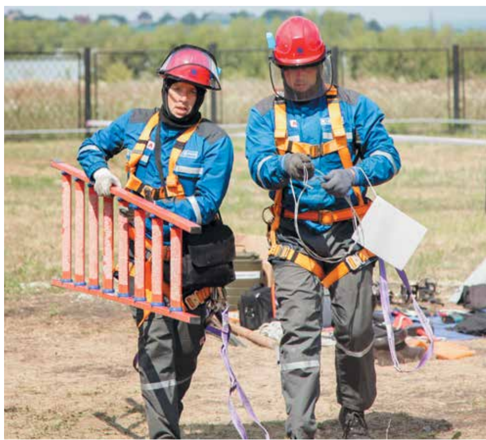
Электромонтеры Алексей Ковалев и Роман Головин (справа) проводят работы на КТП 10–0,4 кВ
