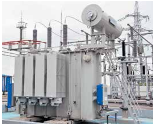
Подстанция «Фабричная» построена в рамках концессии между «МРСК Центра» и региональными властями
