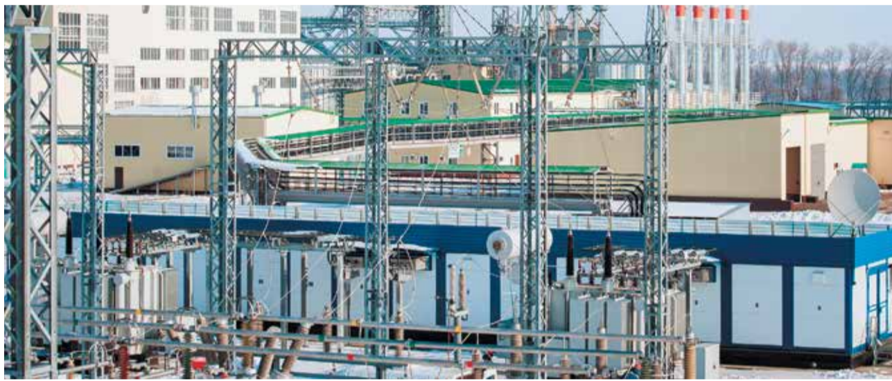
Подстанция «Нежеголь» в Шебекинском районе Белгородской области оснащена самым современным оборудованием
