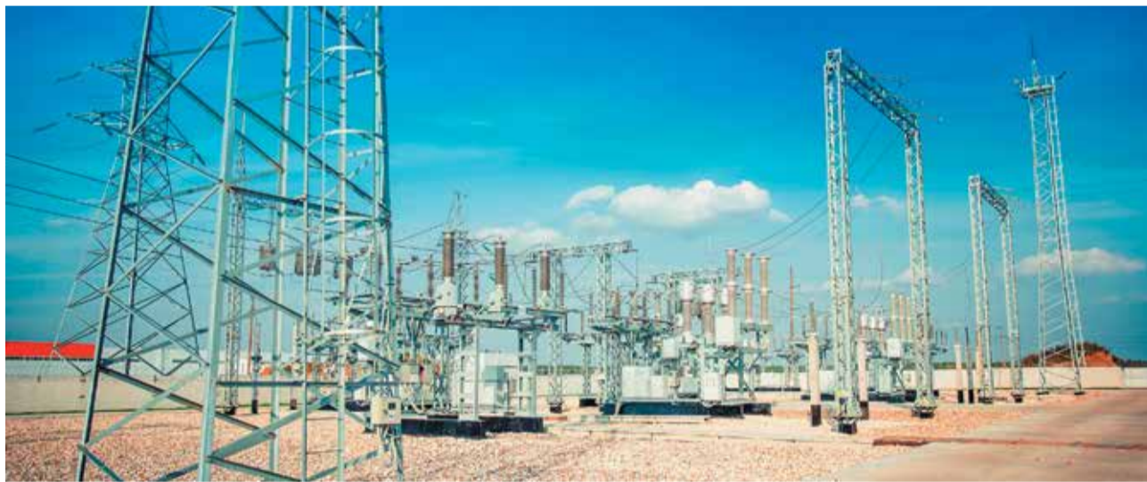
Ключевой проект инвестпрограммы Тверьэнерго – подстанция «Лебедево»
