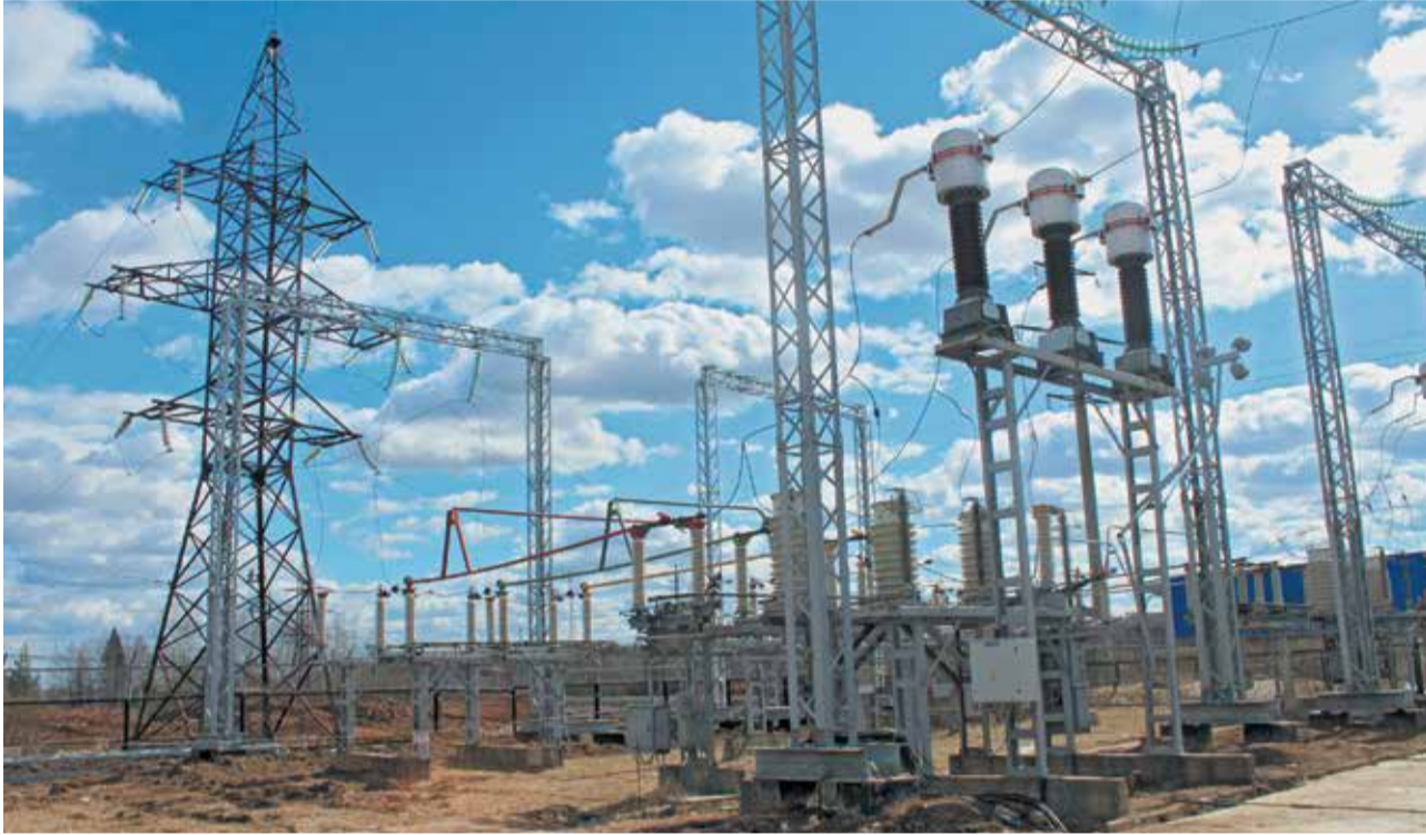
Новый цех по производству оборудования для нефтегазовой промышленности в Костромской области запитан от подстанции «КПД» МРСК Центра
