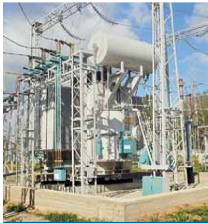
ПС-35–110 кВ «Торжок»
