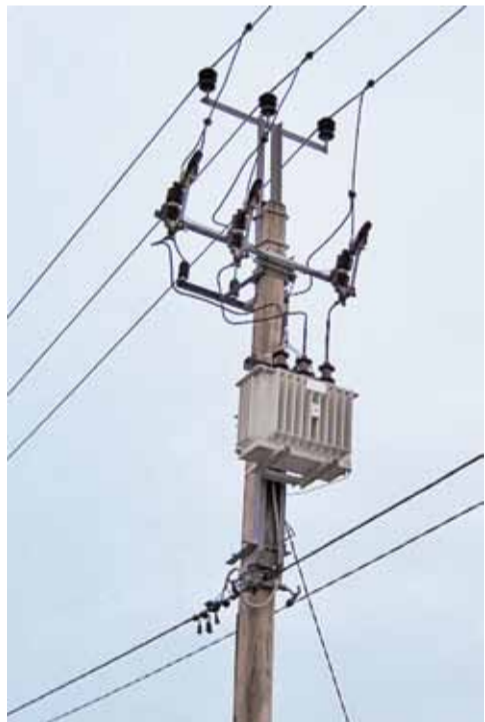
Столбовой трансформаторный пункт
