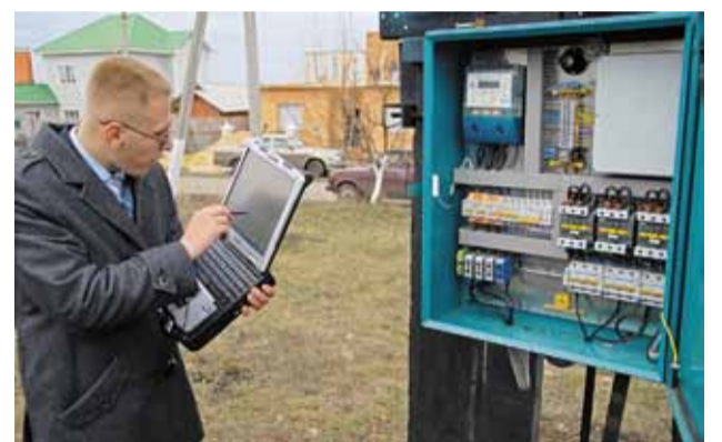
Демонстрация работы автоматизированной системы управления уличным освещением «Гелиос»
